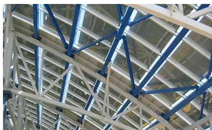
Fotos: Arnold Glas: Solarstromglas für S-Bahn-Station New York
